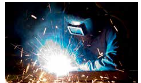
Lassen op de bouwplaats niet nodig
