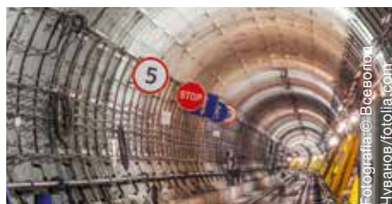
mocowania znaków lub linii zasilających w tunelach.
