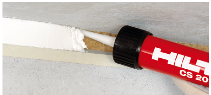
③ Fuge Wand zur Decke.
