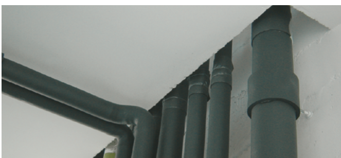
Nichtbrennbare Rohre mit brennbarer Isolierung.
